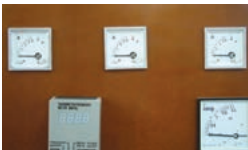
شکل ۱۱-۶- آمپرمترهای اندازه‌گیری جریان فازها
