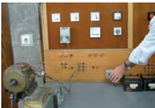
شکل ۹-۶- اتصال موتور به تابلوی برق
